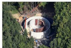
Trinkwasser-Hochbehälter Porta Westfalica
