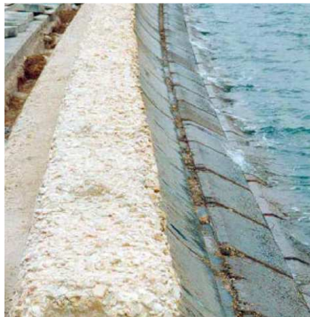
Bild 3: Schadensbild Beanspruchung durch Chloride
