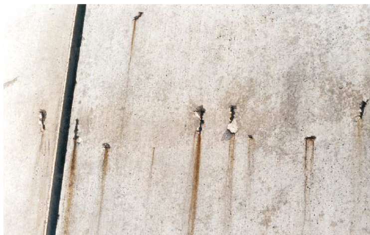
Bild 4: Schadensbild durch Korrosion des Bewehrungsstahls
