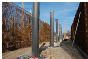
Trinkwasser- Aufbereitungsanlage Essen
