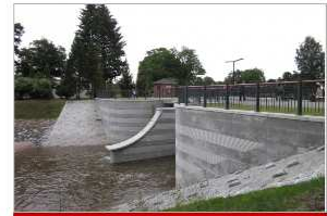
Hochwasserschutz an der Lausitzer Neiße Forst
