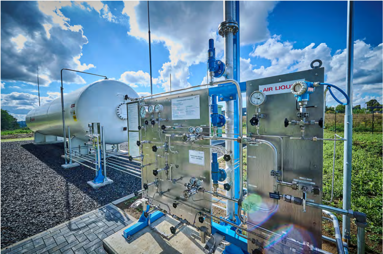
Bild 2: Wasserstoffspeicher mit der zugehörigen Armaturentafel
