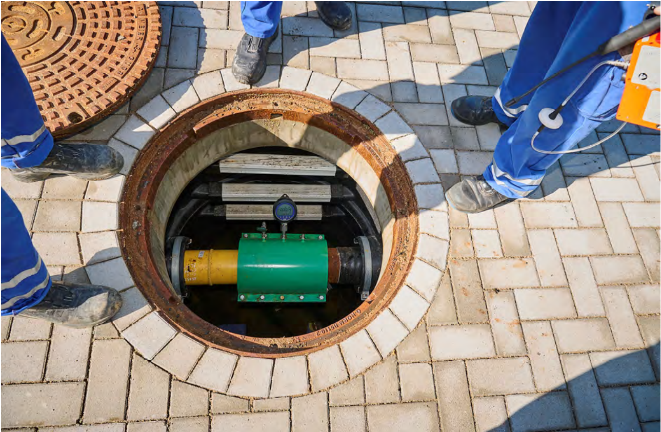
Bild 4: Permeationsmesszelle in einem patentierten Schacht
