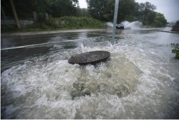
Bild 3: Typischer Überstau infolge eines Starkregenereignisses [9]
