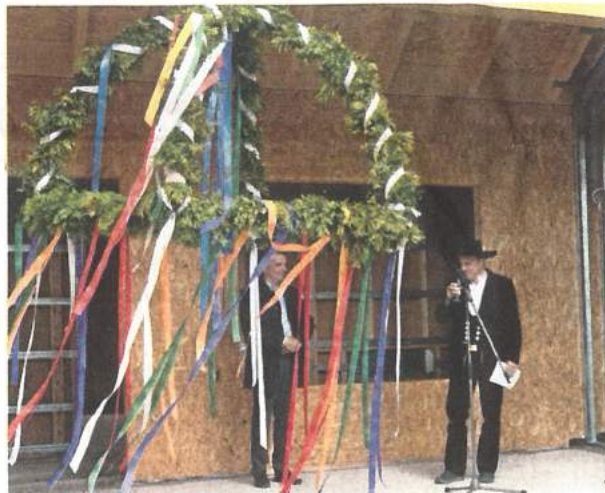
Zimmerer Wolfgang Sauer von der gleichnamigen Holzbau-Firma aus Dingelstädt beim Richtspruch. FOTO: SUSANNE SEIDE
