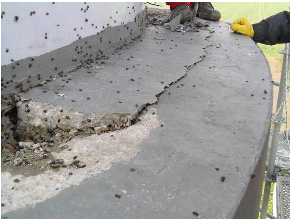
Bild 1: Keilförmige Abplatzung am Fundament durch Bewegung des Turmes
